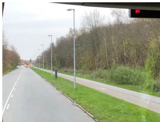
写真-1 占有住宅街区のスマート街灯
