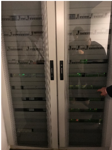
写真-7 システム制御盤
