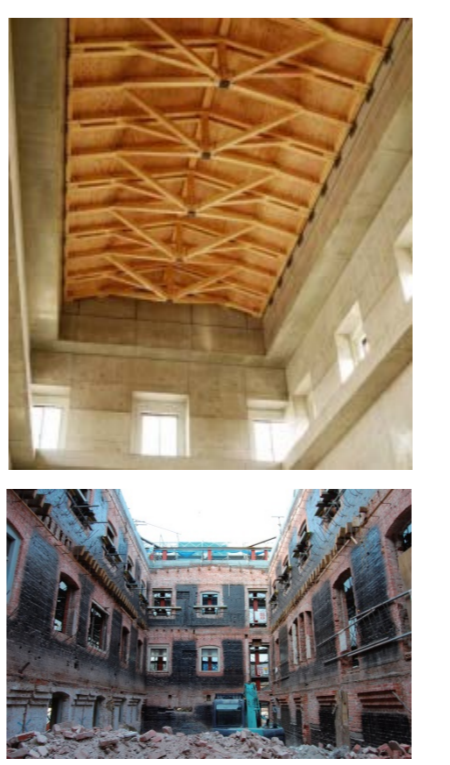
上) RC耐震壁+木トラスでリニューアールされた内部 下) 内部木造床・屋根の解体
