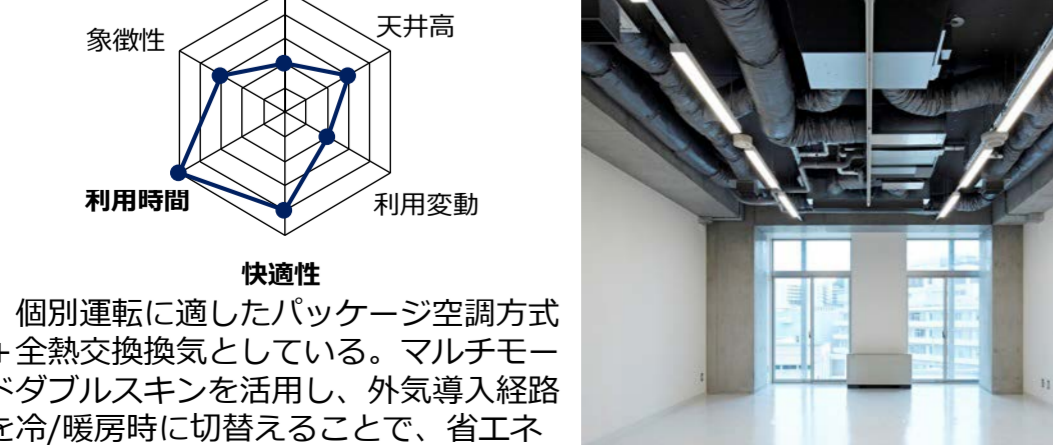
個別運転に適したパッケージ空調方式+全熱交換機として。マルチモードダブルスキンを活用し、外気導入経路を冷/暖房時に切替えることで、省エネを図っている。中間期は、廊下に向する欄間を開け放ち、自然換気を行う。
