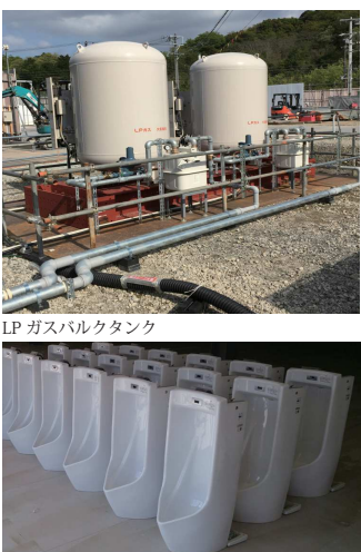
LPガスバルクタンク 便器類は使用後に他の建物でリユース。
