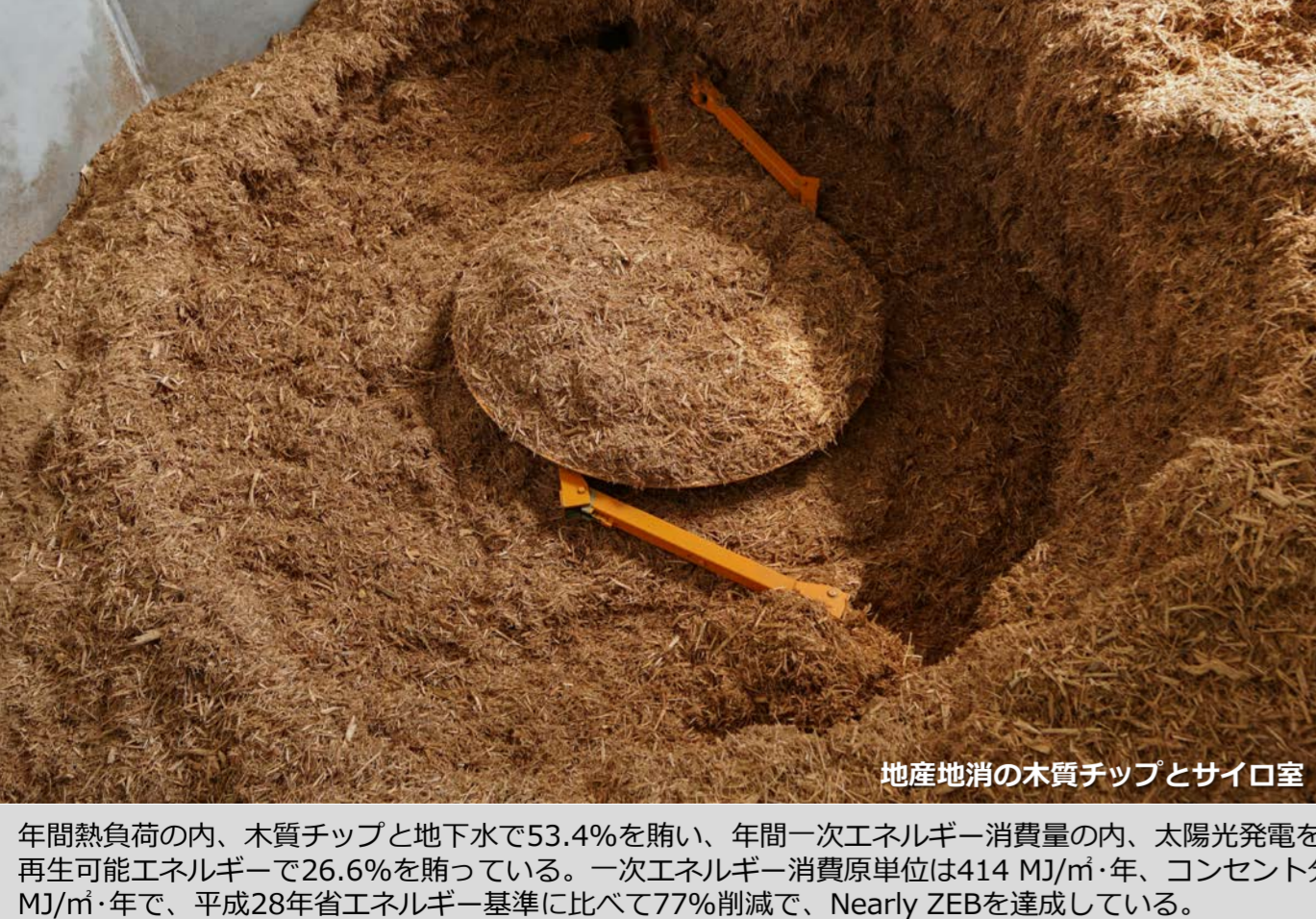
地産地消の木質チップとサイロ室
