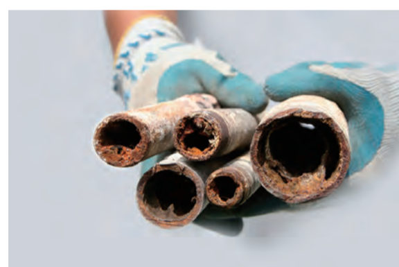
配管内に発生した錆
